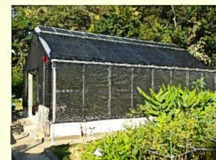
15号園の新設温室
